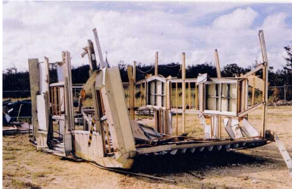
DOD=2 平屋仮設建築物の転倒 (1ユニット単独なので下限値を採用する事例) 写真提供：沖縄県宮古土木事務所
