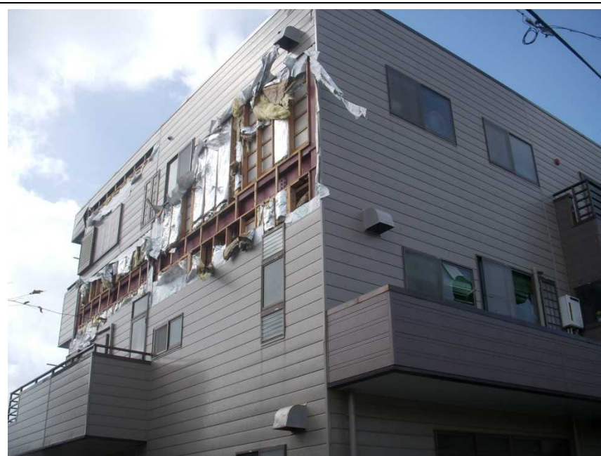
DOD=5 屋根の軒先又は屋根の野地板の破損又は飛散、外壁材の変形・浮き上がり 写真提供：国立研究開発法人建築研究所
