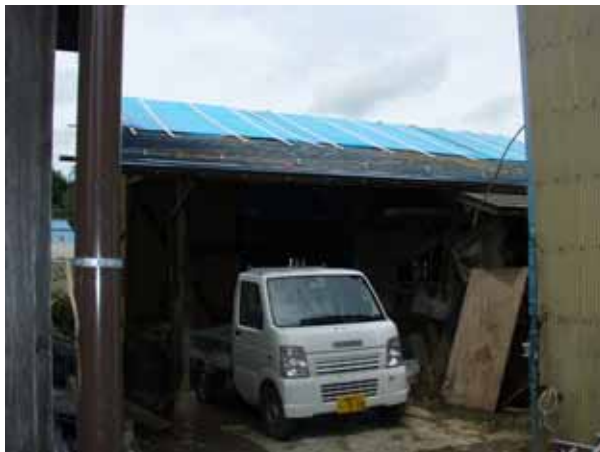
被害地点 _ 屋根を飛ばされた牛舎 ( 撮影 : 南西 北東 )
