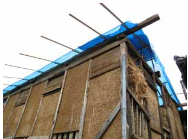
被害地点 _ 屋根を飛ばされた牛舎 ( 撮影 : 北西 南東 )
