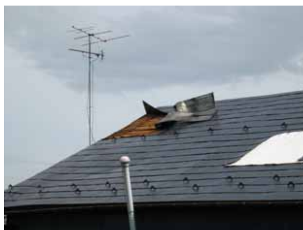
B 地点_トタン屋根の一部破損。 （撮影:北西 南東）
