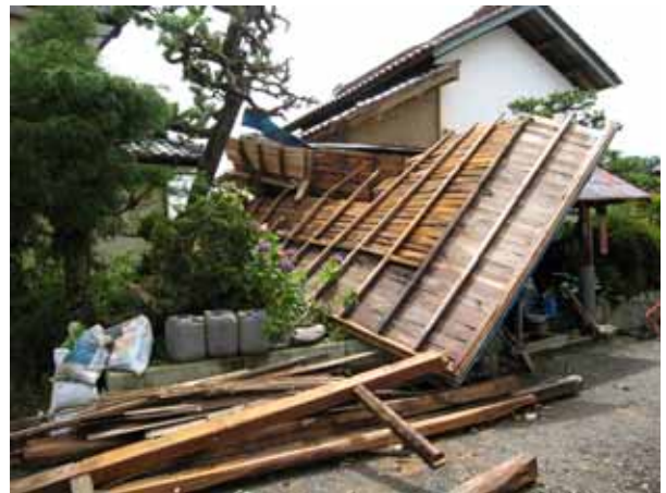
被害地点 _ 飛散したトタン屋根の片側 B ( 撮影 : 北東 南西 )
