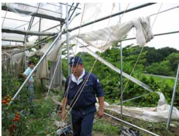
被害地点 _三春ハーブガーデン 骨組みが風圧で曲がり、覆いも飛ばされた。 ( 撮影：東 西 )
