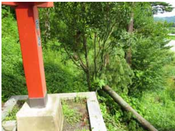
A 地点_被害地点 の倒木 （撮影：北西 南東）
