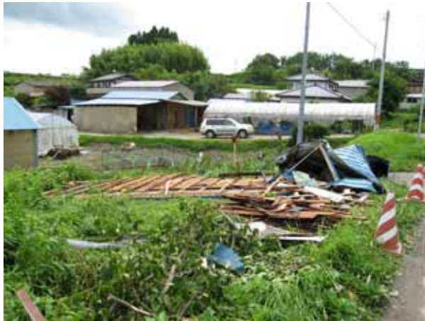
被害地点 _ 飛散したトタン屋根の片側 A ( 撮影 : 東北東 西南西 )
