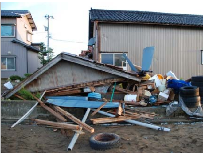
③ 全壊した非住家 (北北東から撮影) 【日末町】
