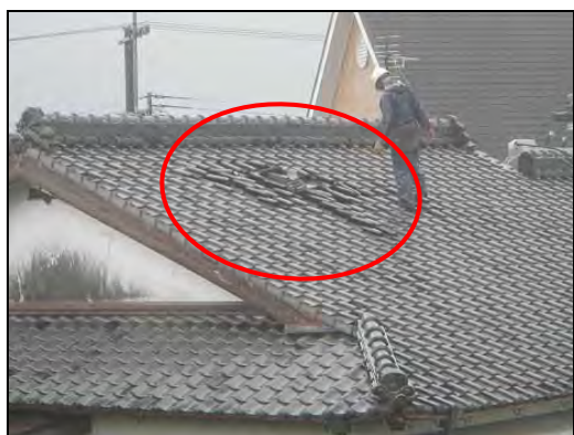
①：屋根瓦がめくれた住家（北から撮影、新富町役場提供）
