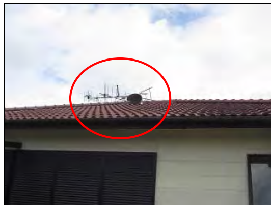
⑥：倒れたアンテナ（南東から撮影）
