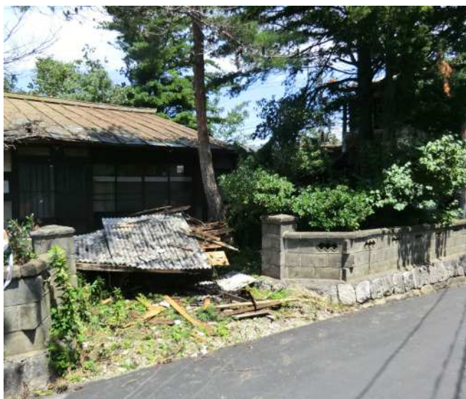
屋根の一部が壊れた非住家 (空家)
