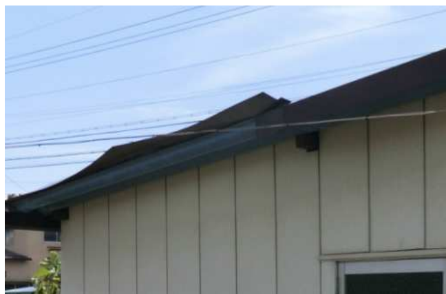
トタン屋根がめくれた非住家
