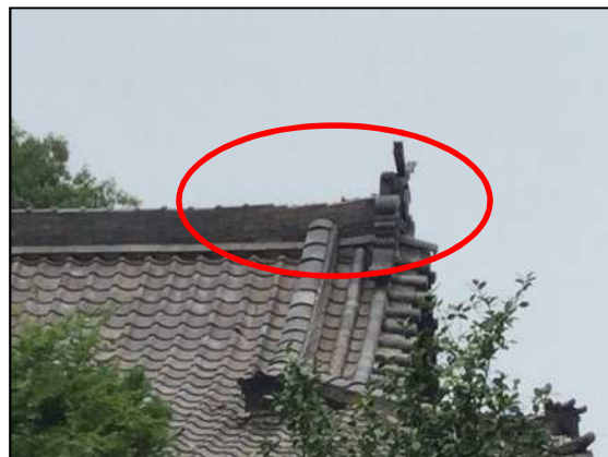
めくれた屋根瓦 （南から撮影）
