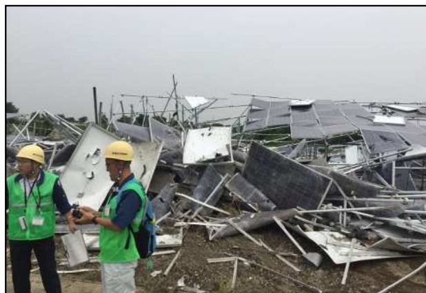
倒壊した太陽光発電施設 （北から撮影）
