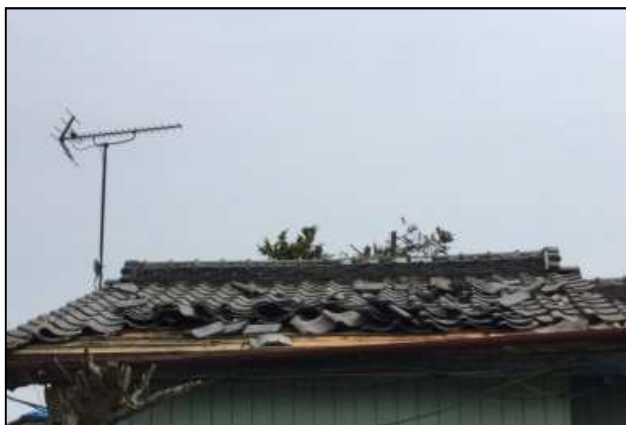
屋根瓦がめくれた住家 （北から撮影）
