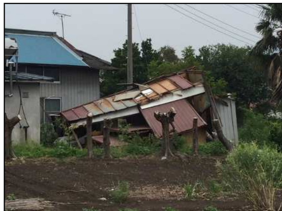
倒壊した物置 （北北東から撮影）
