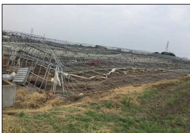
倒壊したビニールハウス （北北西から撮影）
