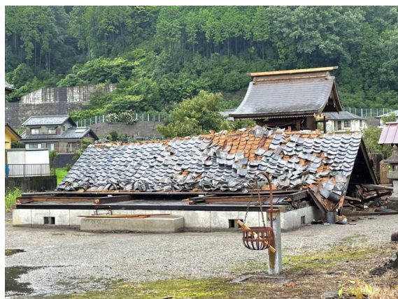
② 拝殿が倒壊した白髭神社 (南東方向から撮影)
