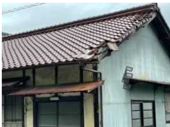
④ 屋根瓦の一部が飛散した非住家 (南東方向から撮影)
