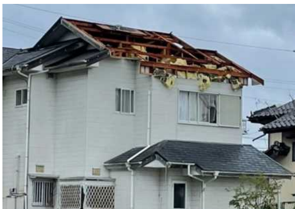
① 屋根の野地板が飛散した住家 (北西方向から撮影)
