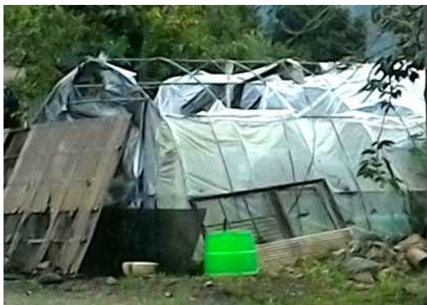
③ ビニールがはく離した農業用ハウス (南西方向から撮影)
