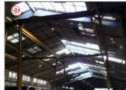
45m/s DI6,DOD3,下限値 鉄骨造倉庫の屋根ふき材の飛散
