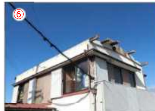
45m/s DI1,DOD7,一段下位の下限値 木造住宅の小屋組の構成部材の飛散
