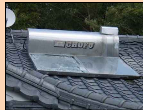
最大2cmの小さな噴石により、太陽熱温水器や太陽電池パネルが破損(火口から約9km) (霧島山新燃岳2011年噴火)
