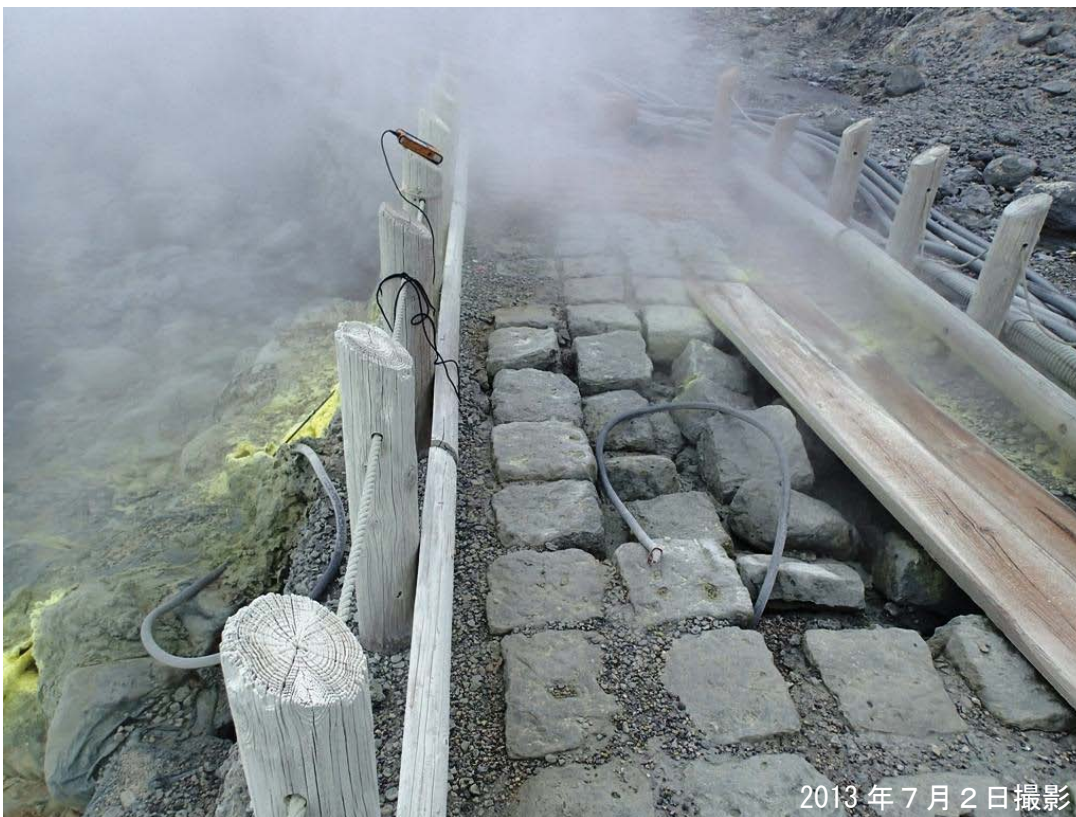
図 5 弥陀ヶ原 地獄谷遊歩道の状況
